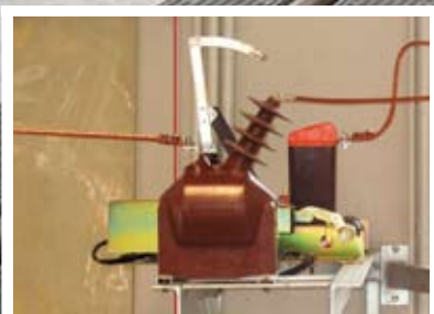
Schalt- und Messeinrichtungen
