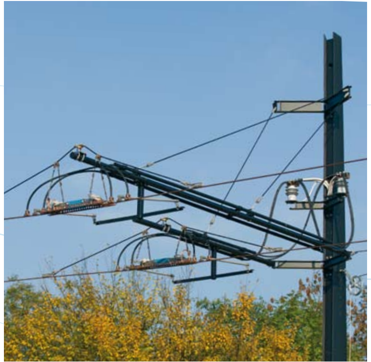
Trennstelle mit vierfacher Sektoreinspeisung
