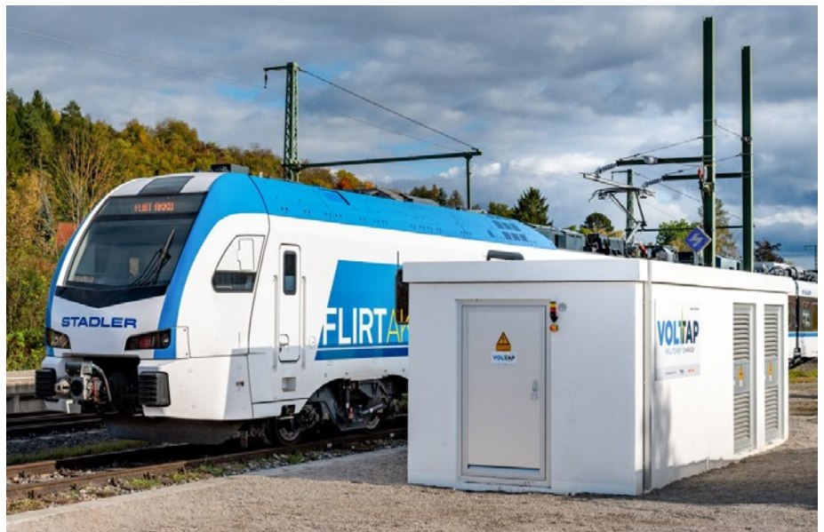
Abb. 4: Stadler Flirt Akku an der Zugladestation „VOLTAP“
