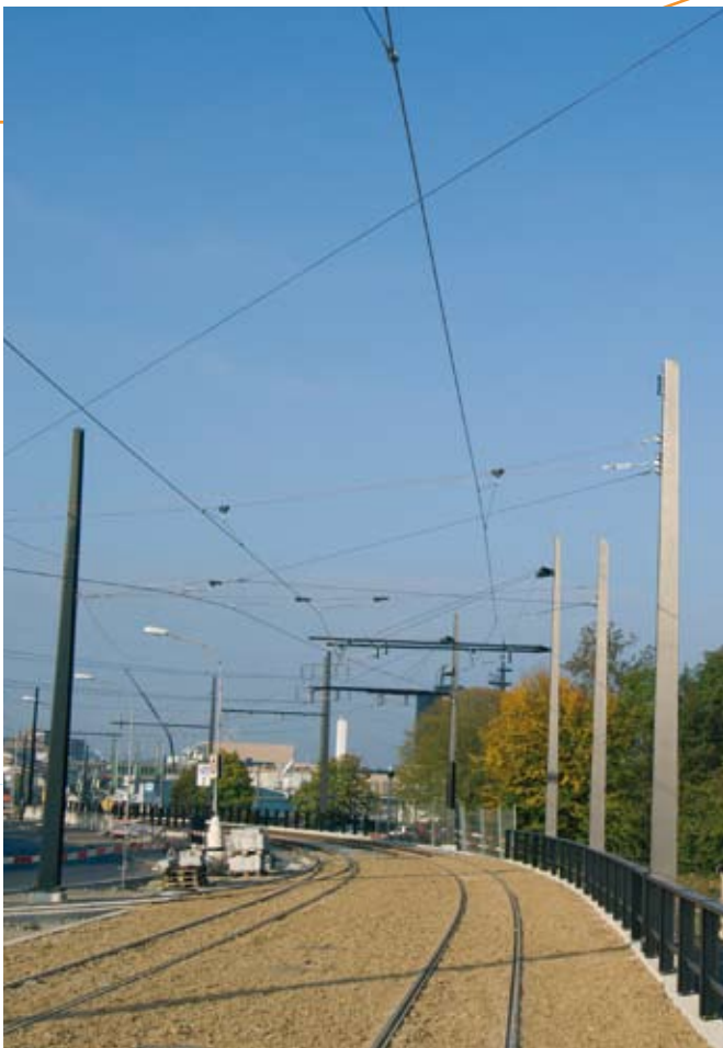
Suspension sur fil transversal avec câble delta
