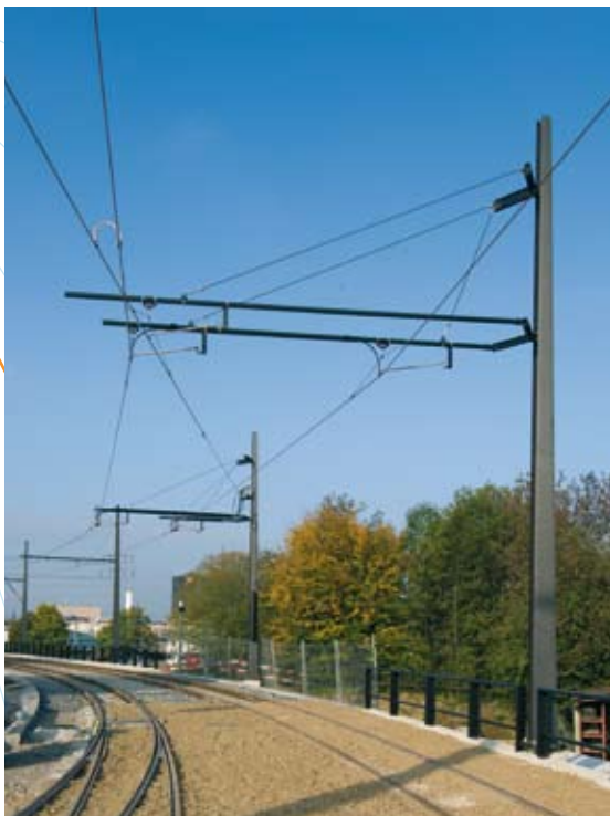
Console double pour appareil de voie
